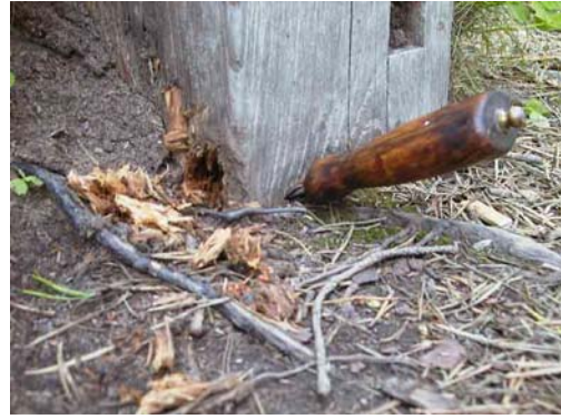
Figur 13. Benkefundament med råteangrep.
