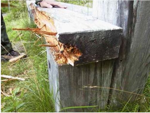
Figur 12. Benk med råteangrep i sitteplanke.
