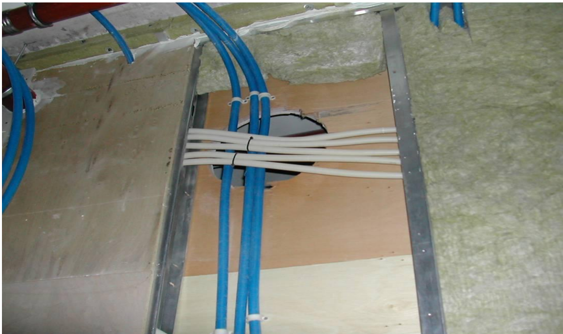
Illustrasjon 2 - Manglende samhandling. Ventilasjon fikk ikke sitt rør på plass før elektriker og rørlegger kom med sine. Kilde Helsebygg Midt-Norge
