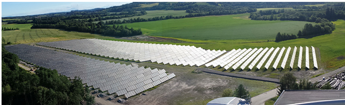
Solfangeranlegget, Akershus EnergiPark (aeas.no)
