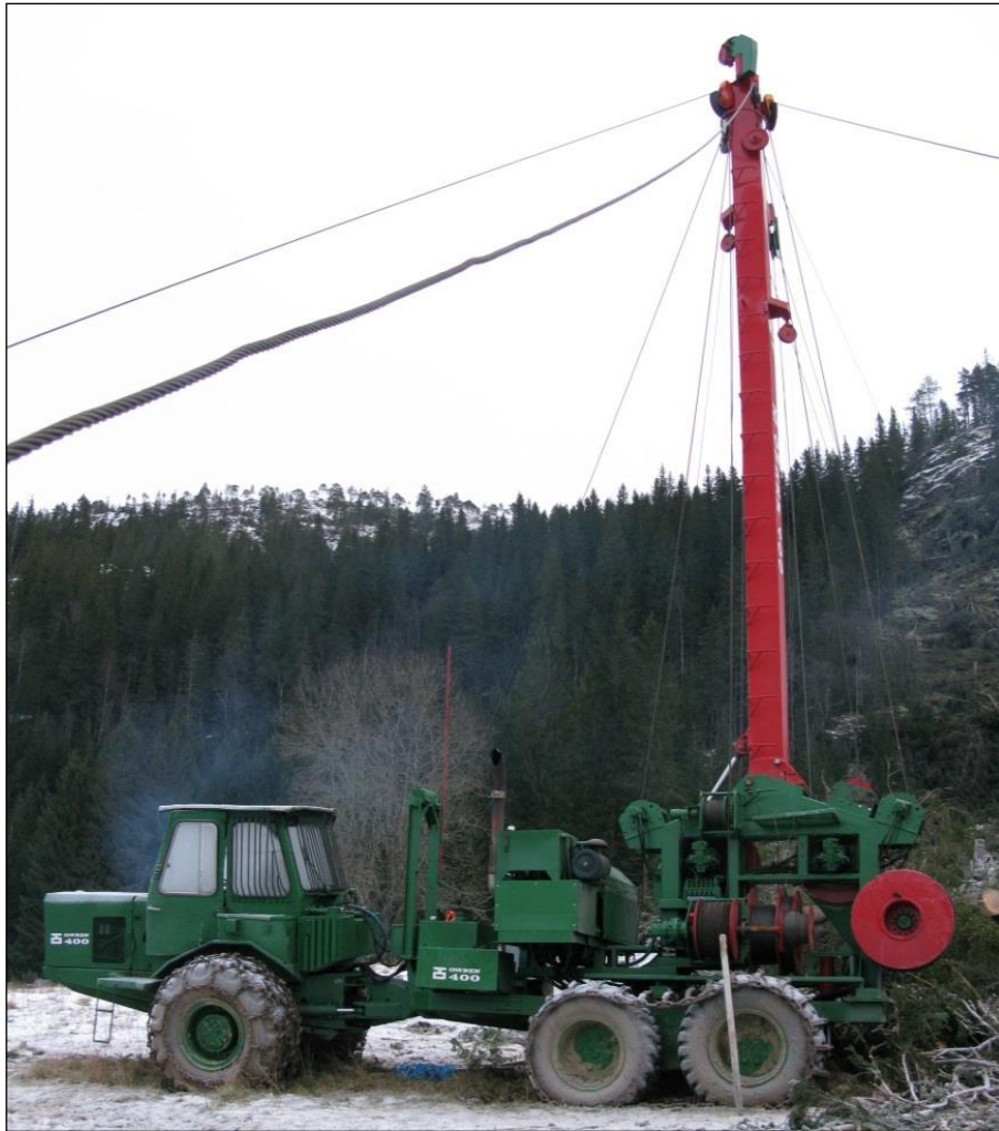
Norskbygget kabelkran Owren 400 montert på en rammestyrtraktor. Den har god framkommelighet slik at den kan plasseres på et hensiktsmessig sted. Foto: Nils Olaf Kyllø
