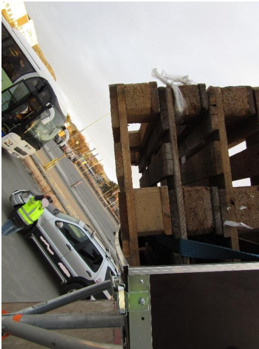
Figur 13 framvegg viser usikker tåleevne
