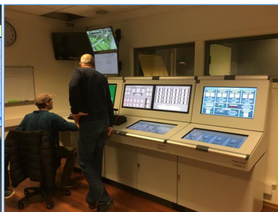
Bilde 5 maskinkontrollrom (Foto: Rune Elvegård)
