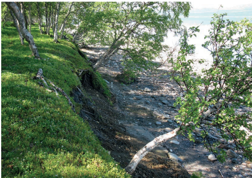
Bilde 5: Erosjonsskader i 2013, nærmere 60 år etter oppdemminga. Foto: Jostein Lorås.
