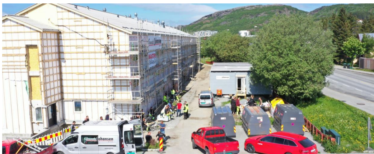
Bilde fra Gunvald Johansen Byggs Facebook side av studentblokker som renoveres sommeren 2021.
